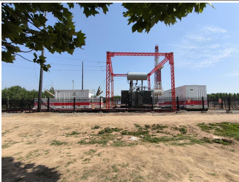
110kV 撬装变电站
